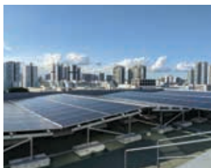
202 Kallang Bahru屋頂上的太陽能板
